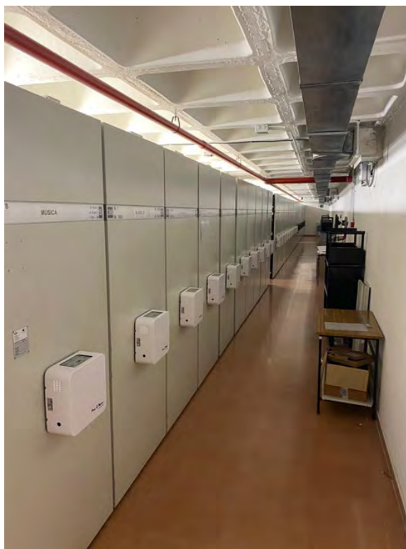
Рис. 2. После модернизации. Передвижные стеллажи с электроприводом с установленным оборудованием Plug & Move®
